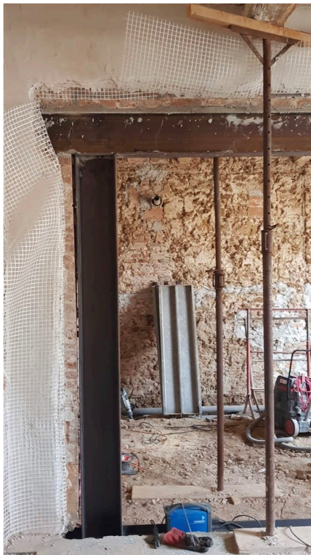
Figura 1 Cerchiatura con rinforzo delle murature con betoncino a base di calce e rete in fibra di vetro
